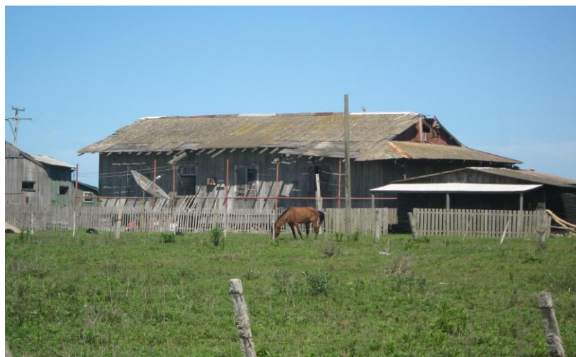
Figura 3: Fotografia registrada em 2009 de uma das primeiras casas em péssimas condições construídas na Barra. Fonte: Autora, em 15/10/2009.
